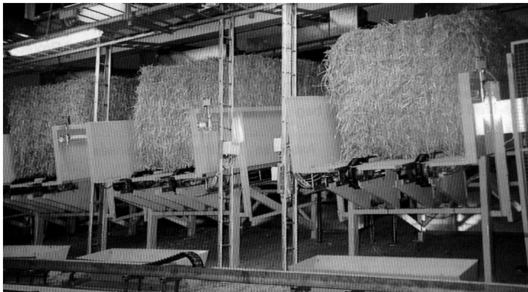
Alimentation automatique de la paille dans l'installation de cogénération de Masnedo
